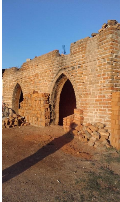
Figura 22. Horno bi-cámara con arcos fijos construido en Irapuato
