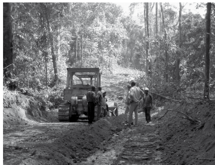
Construcción de una carretera en la concesión industrial de Wyma, provincia Suroeste. Foto cortesía: W. Smith
